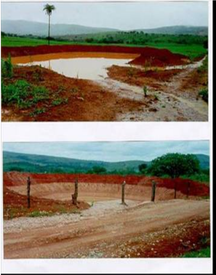
Foto 11 – Bacias de Infiltração
